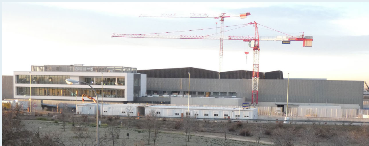
Vista general de la obra de construcción de la nueva planta de IMBISA.
